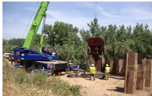
"Arqueta de bombeo en el río Jalón - Morés" Morés (Zaragoza) - 2.009 (1)
