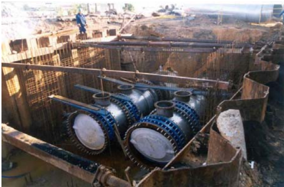
"Arqueta de bombeo en el río Jalón - Morés" Morés (Zaragoza) - 2.011 (1)
