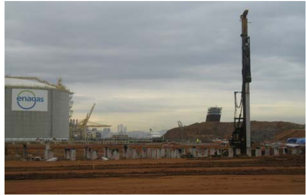
"Central de Ciclo Combinado - Puerto" / Sacyr Barcelona - 2.008 (2)
